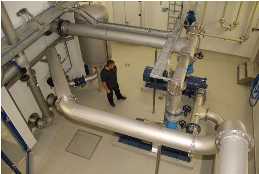
Abbildung 5: Wasserwerk im Großen Bruch
